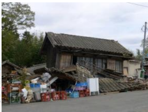
4/11 の余震で倒壊（調査は 4/21）
