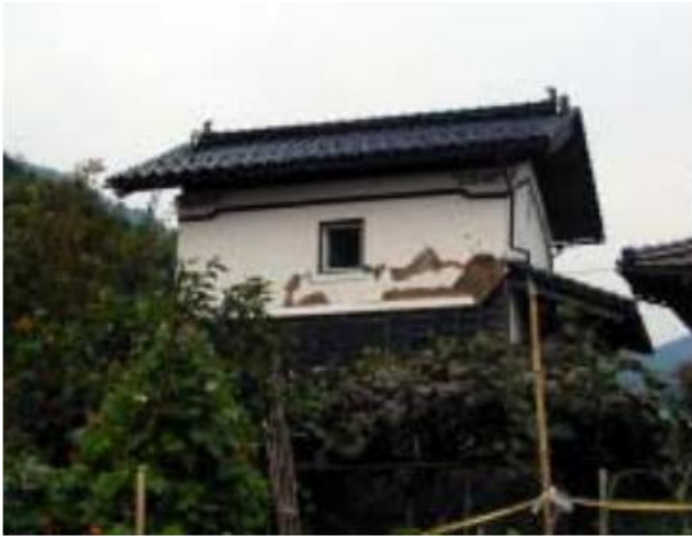
土蔵の被害（日野町下榎）
