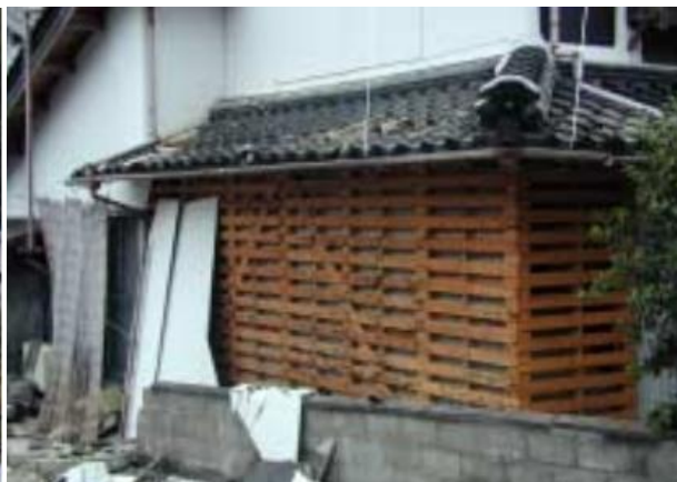
住宅のラスモルタルの崩落（日野町下榎）
