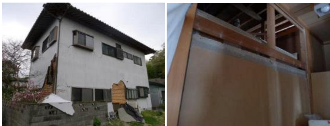
外壁モルタルの剥落残留変形：1階－1/500 rad 2階－1/300 rad 内装ボードの剥落
