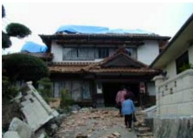
1 階が大きく傾斜した木造住宅（日野町下榎）
