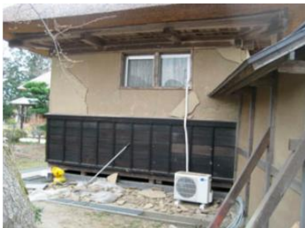
写真 3.3-6 洞口家住宅の外壁剥落（宮城県名取市）
