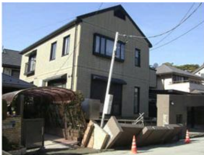
浦安市における住宅被害
