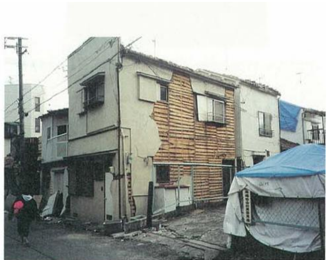
写真3.2.3.15 〔復旧事例、大石2〕被災後の状況（1995年2月）
