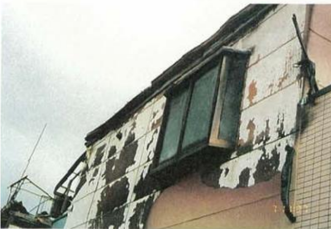
建築年代が比較的新しく、網入りガラスの入ったアルミサッシ窓を有する建物が焼け止まりとなる事例
