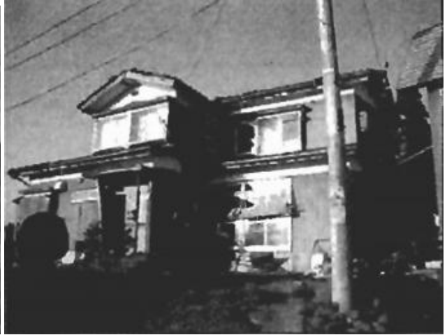
危険＝基礎に亀裂、棟瓦落下
