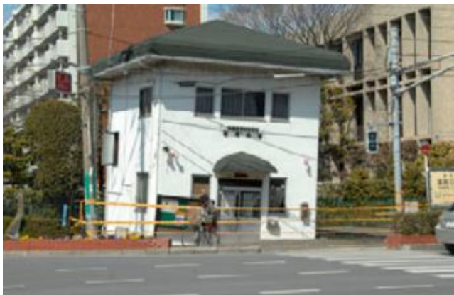
写真 3.3-7 液状化により傾斜した交番（千葉県浦安市富岡地区）
