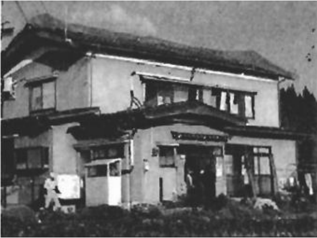
要注意＝基礎に亀裂、棟瓦一部落下
