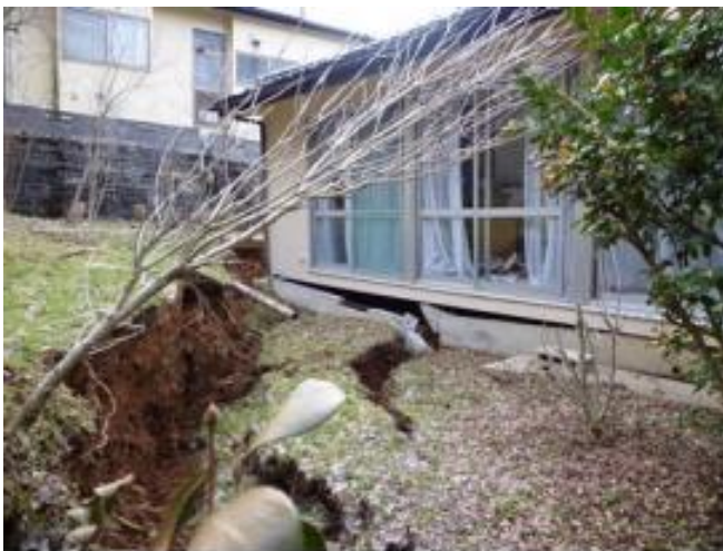
基礎が 90cm 程度沈下、破壊
