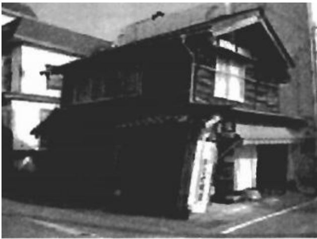
危険＝店舗 1 階傾斜大
