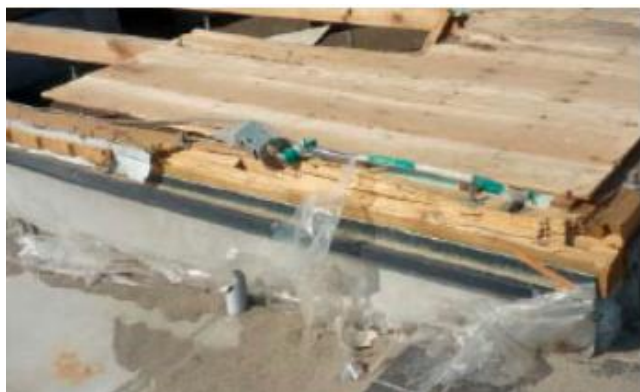
写真 3.3-9 1階の床板が残存した事例 (宮城県亘理町荒浜地区)
