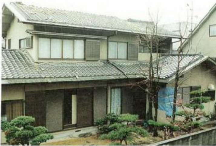
写真3.2.3.54 Y氏宅 被害後の状況（南西より）
