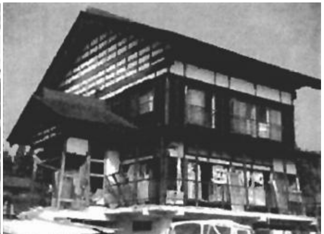
危険＝1階部分傾斜大
