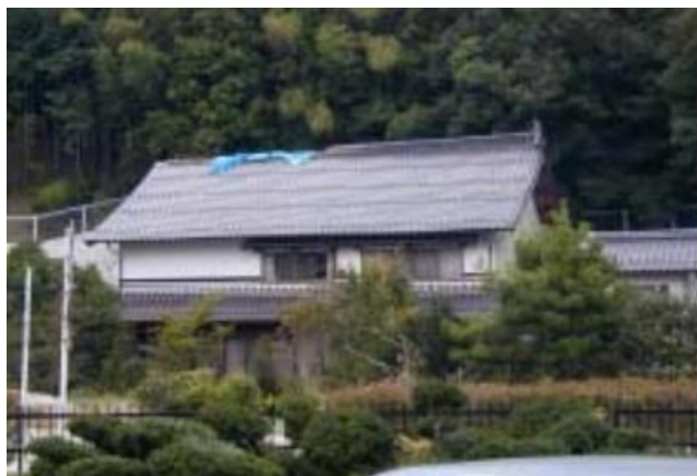
木造住宅の棟瓦の滑落（日野町根雨）
